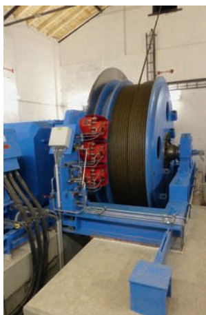
Fördermaschine im Fördermaschinenhaus mit Verlagerungsrahmen und Antriebsschwinge
