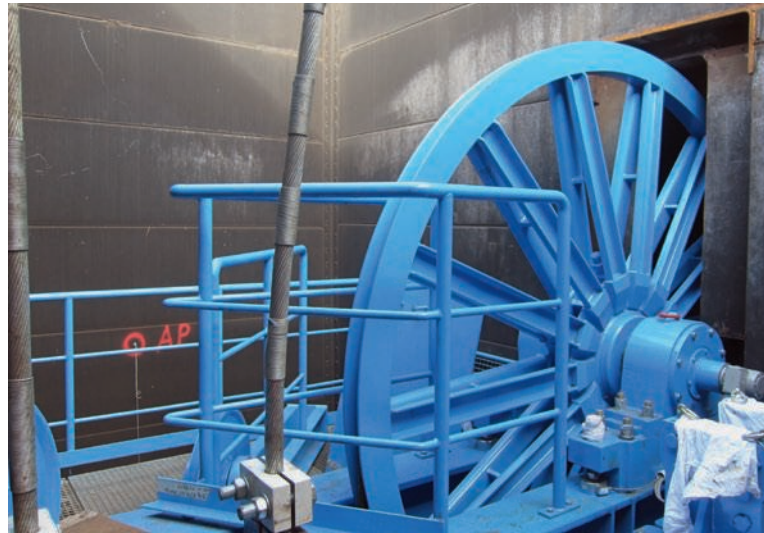
Seilscheibenbühne im Wetterschlot mit Förderseilscheibe und Führungsseileinband
