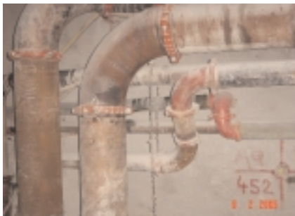
Versorgungsrohrleitungen für den Vortrieb
