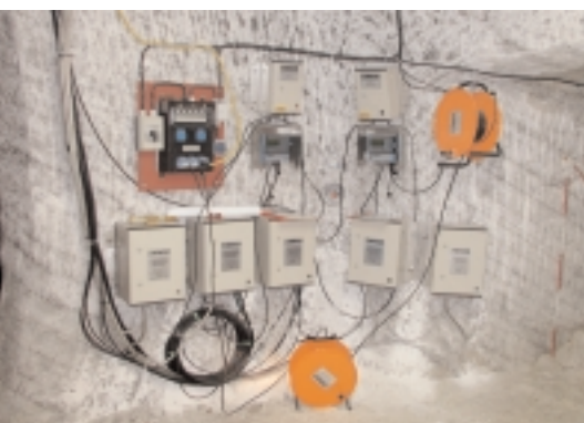
Bild links: Geotechnische Messeinrichtung im zu verfüllenden Abbau
